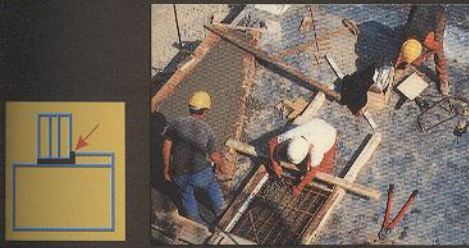
Vibration Insulation of Wall to Floor Isolation des murs et sols contre les vibrations Vibrationsisolation von Wand zu Boden
